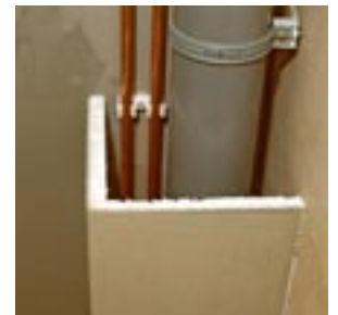
Zeer eenvoudig wegwerken van leidingen en afvoeren.
